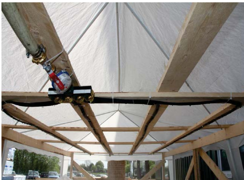
Übersichtsaufnahme des Wasserverteilungssystems mit Wasseruhr, Durchflussregler und perforierten Schläuchen
