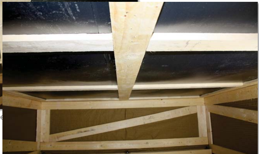
Innenansicht der Kiste B nach der Beregnung ohne Spuren einer Wasserdurchlässigkeit (Variante B, 100 \frac{L}{m^2h} , Tabelle 4, Ansicht 2)
