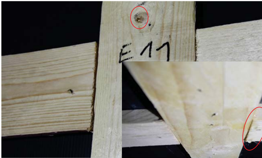
Teilansicht Kistendeckel A - Blick von Wasser durch Nagelstelle und (Variante A; 10 \frac{L}{m^2h} ; Tabelle 2, Q
